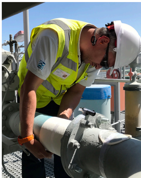
Instalación en la línea de alimentación de aire.
